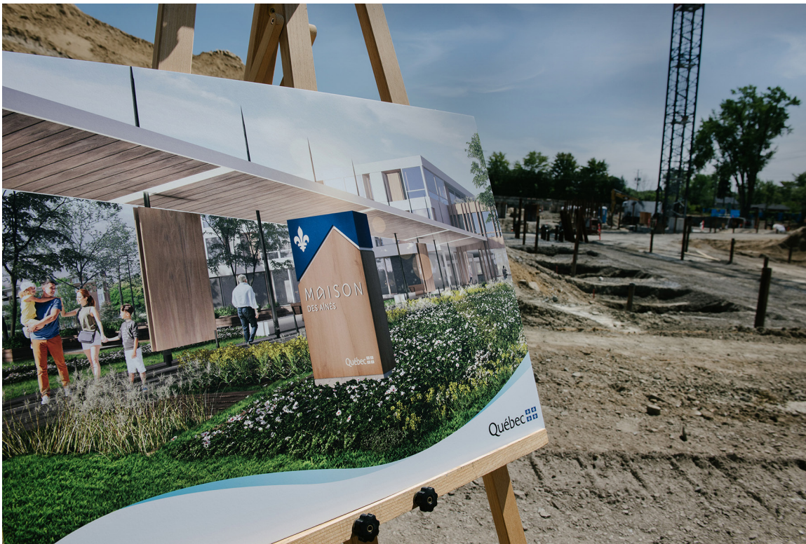
Sur le site de la Maison des aînés et alternative de Blainville
