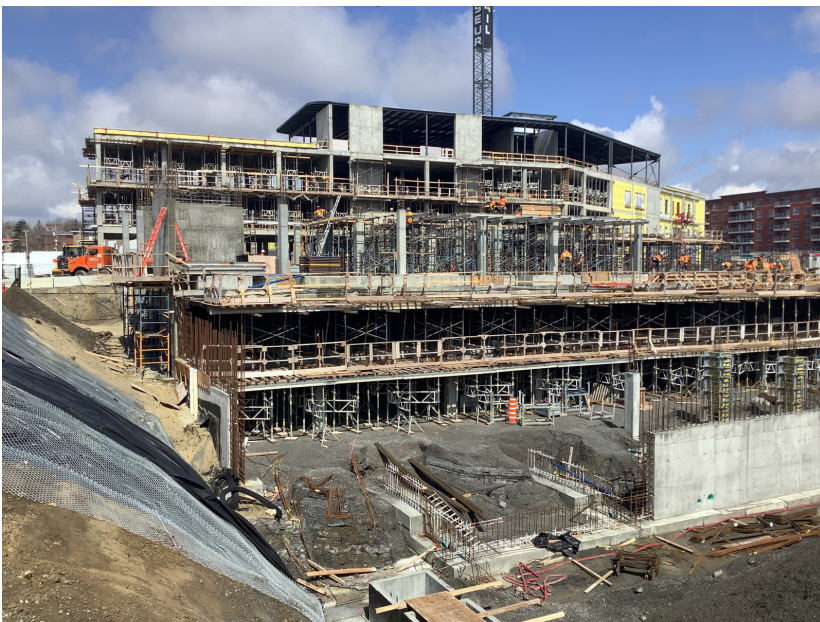
Chantier de construction du futur centre de réadaptation pour jeunes en difficulté d'adaptation (CRJDA) à Sainte-Thérèse
